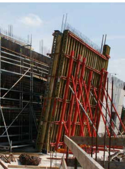
Die komplexe Gebäudegeometrie mit geneigten und bis zu 17,50 m hohen Wänden stellten in der Bau-phase eine besondere Herausforderung dar.
