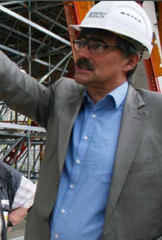
Westag-Fachberater Gerd Ploeger (r.) stand bei der Auswahl der richtigen Schalhaut und auch bei der Umsetzung auf der Baustelle beratend zur Seite. Hier im Gespräch mit Bauleiter Sebastian Hering auf der Baustelle.
