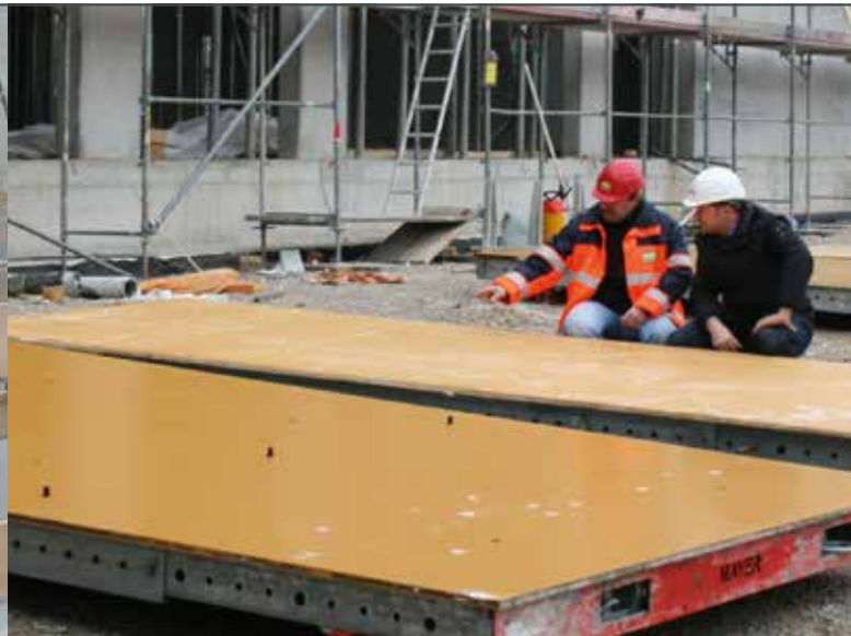
Kaum Abrieb auf der Westaspan-Schalhaut. Mit dieser Schalhaut werden matte Betonoberflächen erzielt.
