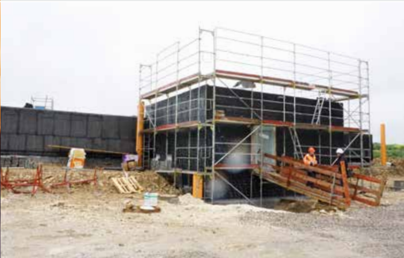
Von links nach rechts: Gerd Bühler vom Bau- amt der Stadt Langenau und Bauleiter Stefan Bartl vom Bauunter- nehmen Kurt Motz e.K., begutachten gemein- sam mit Westag- Fachberater Michael Hörmann das Bauwerk.
